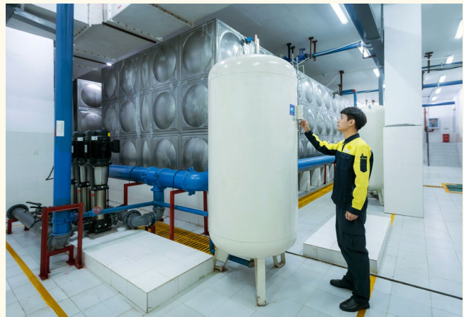
工作人員正在向業主介紹設備房 ▲
